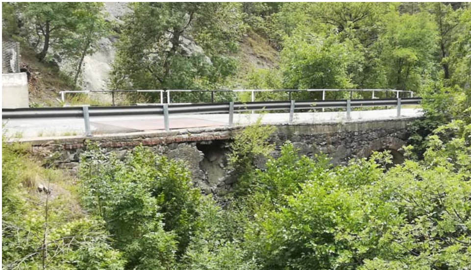
Figura 8 - Particolare cedimento muro
