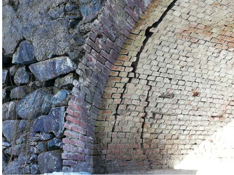
Figura 4 - Particolare distacco coronamento in mattoni
